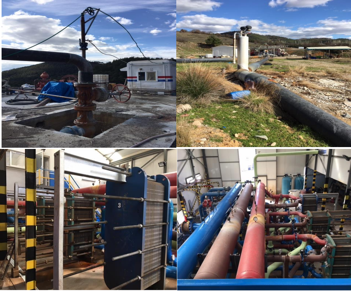
Şekil 3. Jeotermal ısı merkezinden görünüm.
